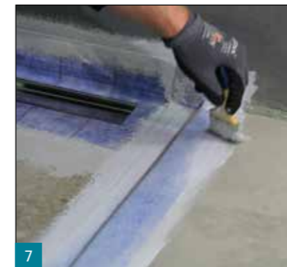
7 Die werksseitig angebrachte Manschette der Linienentwässerung, das Systemdichtband SB 78 und die Zubehörtteile werden in die erste Lage der Abdichtung eingearbeitet.
